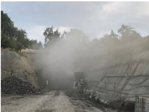
Abbildung 58: Rauchentwicklung am Tunnelportal
